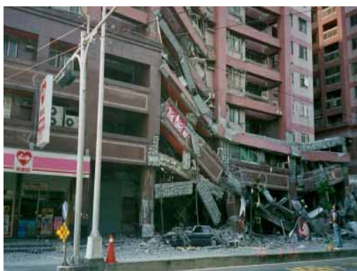
照片 A13、台中市德昌大樓破損情形。
