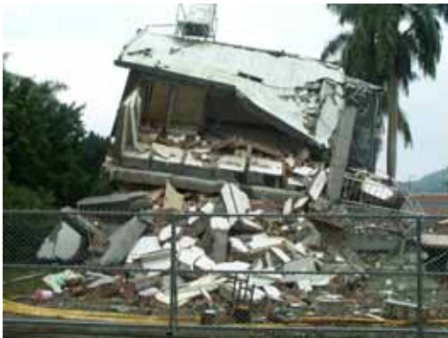
照片 A9、霧峰光復國中教室破壞情形。
