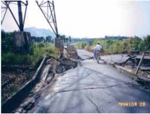
照片 B1、草屯鎮隘寮橋岸道路下陷。
