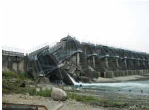
照片 A4、石岡水壩北側壩體受損情形。
