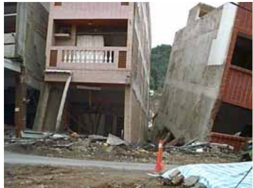
照片 A10、台中廓子坑路民房破損情形。
