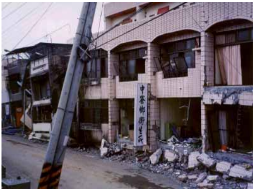
照片 A11、中寮鄉衛生所一樓被震垮。
