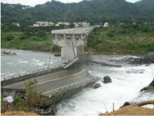
照片 A1、位於大甲溪上的碑豐橋破壞情形。
