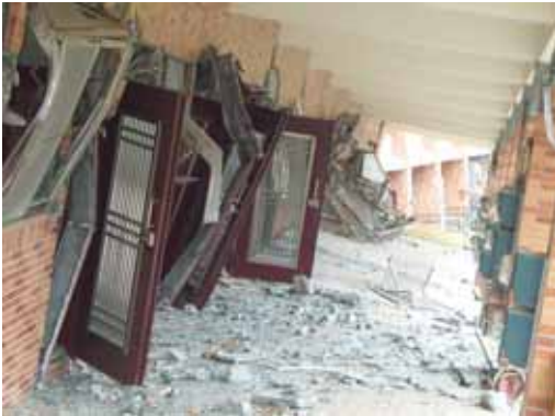
照片 A3、豐勢路附近某新建社區騎樓破損情形。
