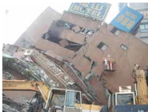
照片 A14、台北松山區東星大樓倒塌現場。
