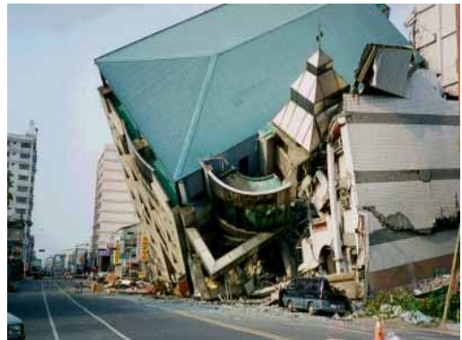
照片 A12、霧峰鄉中正路上一棟建築倒塌現場。
